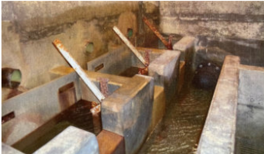
Die derzeitige Sammelbrunnenstube.
