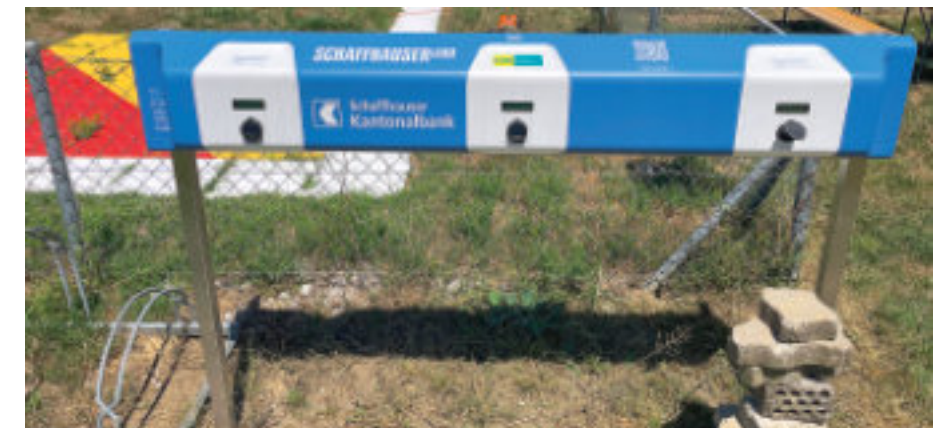
Die Ladestation für die E-Bike-Akkus kann kostenlos benutzt werden.
